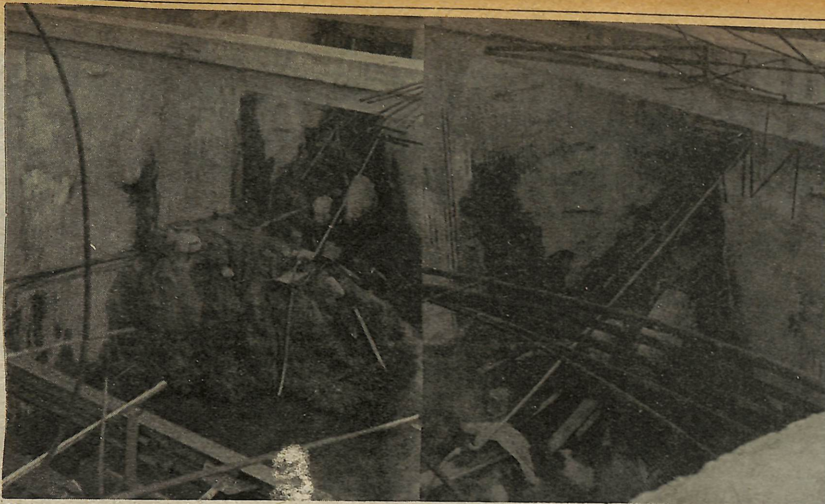
No reservatório, a situação é bastante grave, pois parte de uma das paredes de concreto ruiu. Mesmo assim, o estado de abandono permaneceu.
